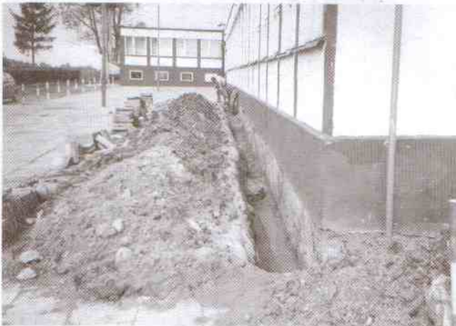
Aby usunąć zawilgocenia trzeba odsłonić fundamenty
