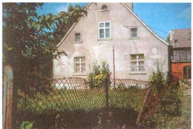
Zaniedbany budynek po b. poczcie w Łącku.
