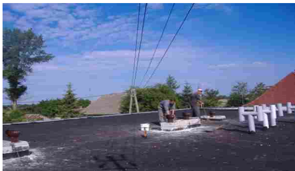
Na zdjęciu: ekipa remontowa z usteckiego zakładu rzemieślniczego Adama Rojka podczas zakładania nowych kominów.
